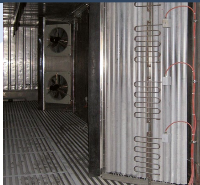
Heizregister elektrisch und Warmwasser
