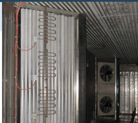
Heizregister elektrisch und Warmwasser
